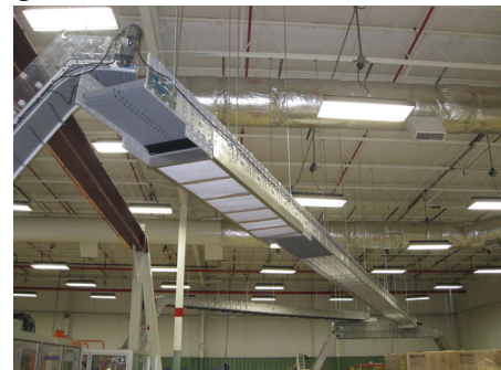
El sistema transportador de aire filtrado colgado en el techo de 24" de ancho libera espacio en el piso.
